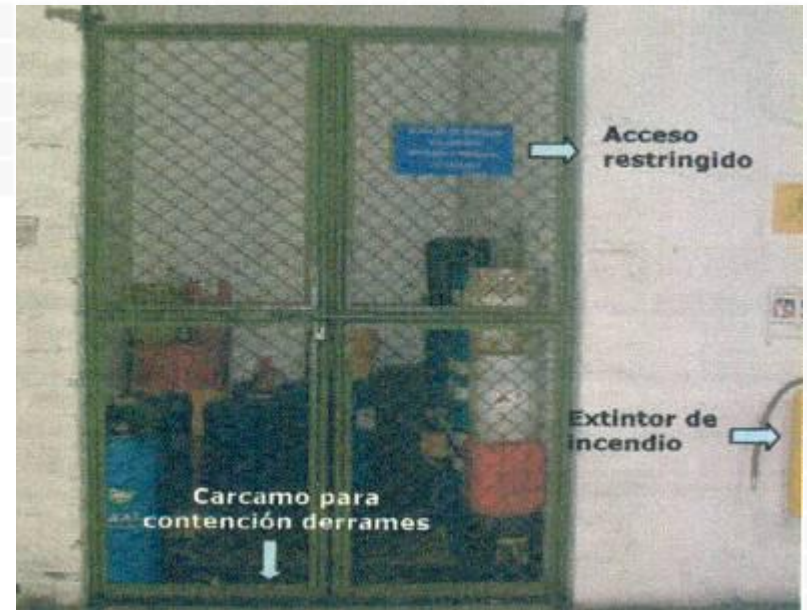
Almacenamiento de residuos peligrosos
